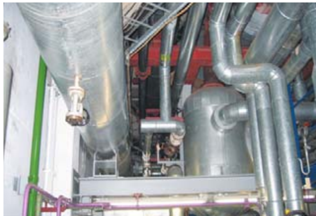
Rohrleitungen im Turbinenkeller
