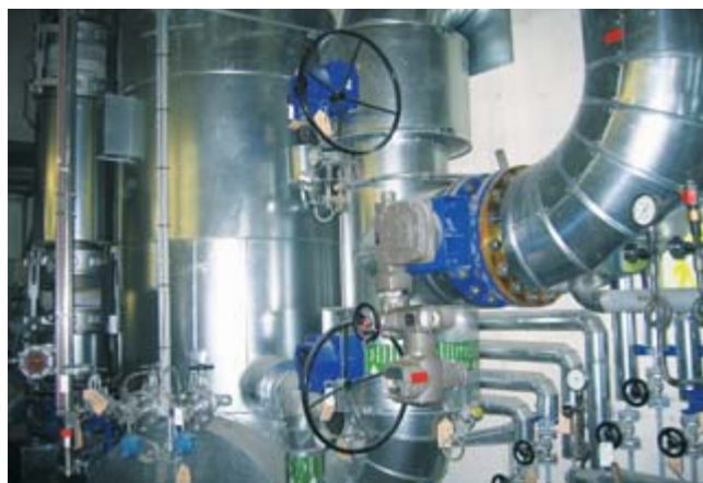
Wärmetauscher D zur Erzeugung von Fernwärme
